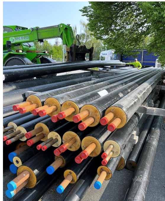
På bilden syns fjärrvärmerör som är redo att användas till utbyggnad av vår fjärrvärmekulvert.
