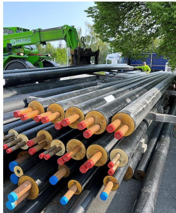
På bilden syns fjärrvärmerör som är redo att användas till utbyggnad av vår fjärrvärmekulvert.
